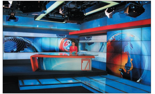
Телестудия в г. Астане, оборудованная полиэкранный системой на базе ЖК-панелей NEC
